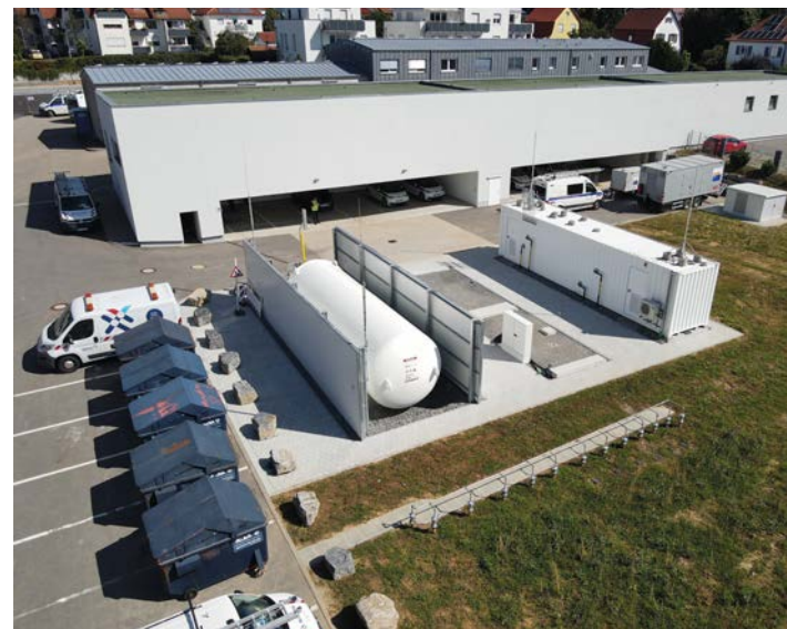
Seit Mitte Dezember 2021 versorgt die Wasserstoff-Insel Öhringen im ersten Schritt die eigene Betriebsstelle mit einem Erdgas-Wasserstoff-Gemisch.
